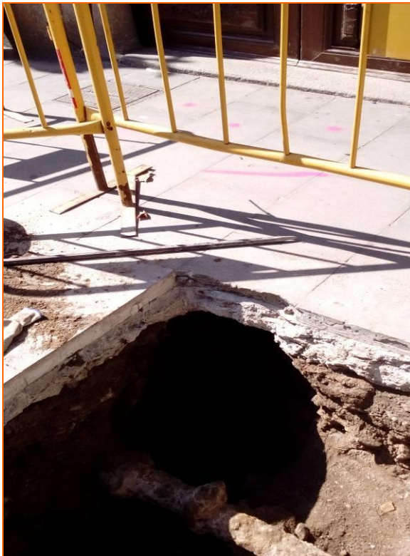
Foto 10. Ubicació de la rasa de connexió del clavegueró a l'escomesa de la finca.
