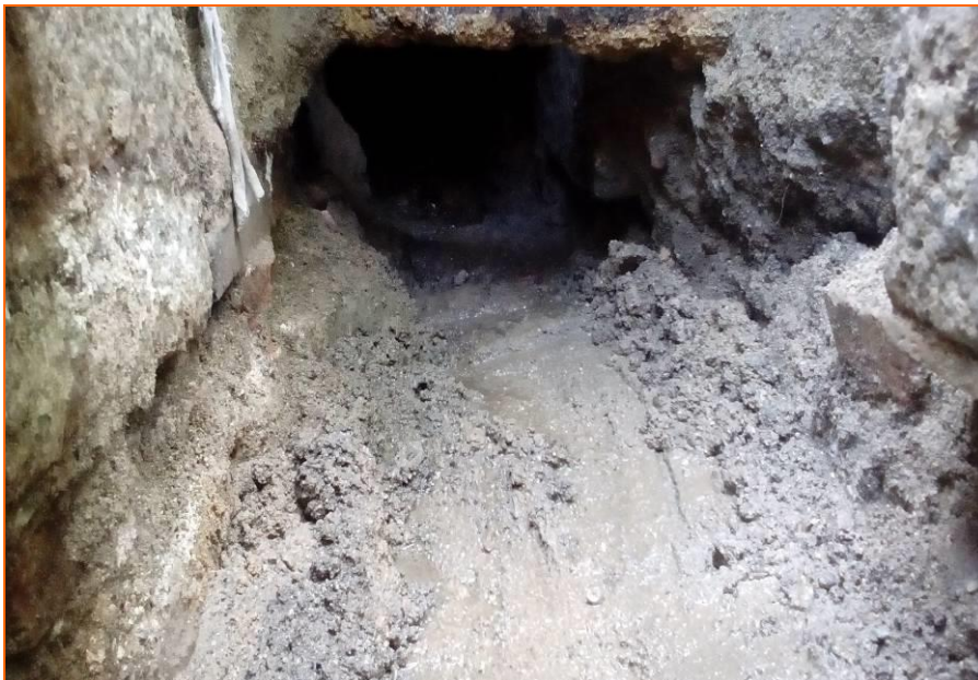
Foto 12. Excavació en mina de la rasa de connexió seguint la clavoguera del segle XIX UE 6.
